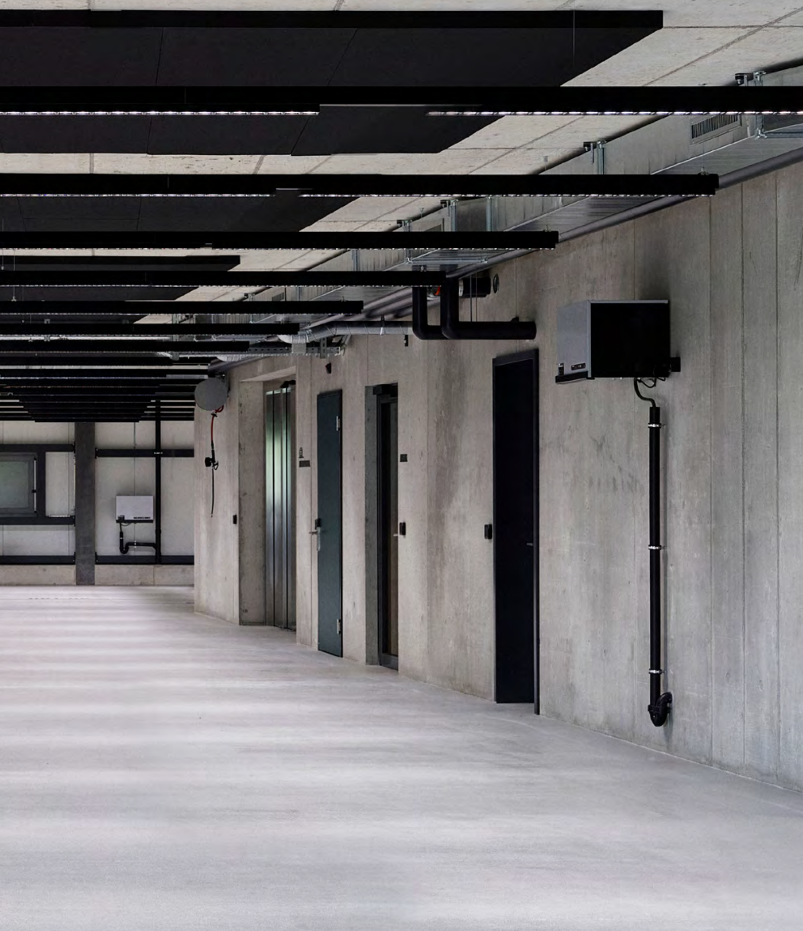
Unsere Speziallösung in der Autohalle Andelfingen
