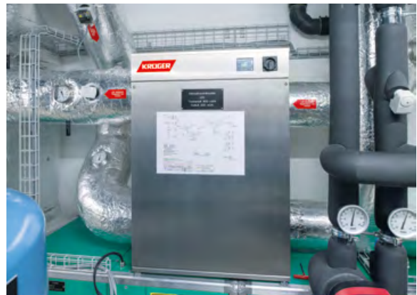
Kellerräume werden dauerhaft trocken gehalten.
