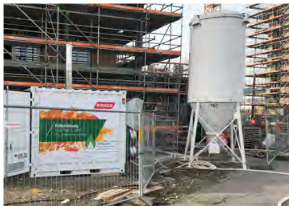
Riscaldamento a pellet da 220 kW
