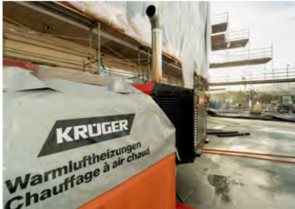
Gestion de mazout par nos soins
