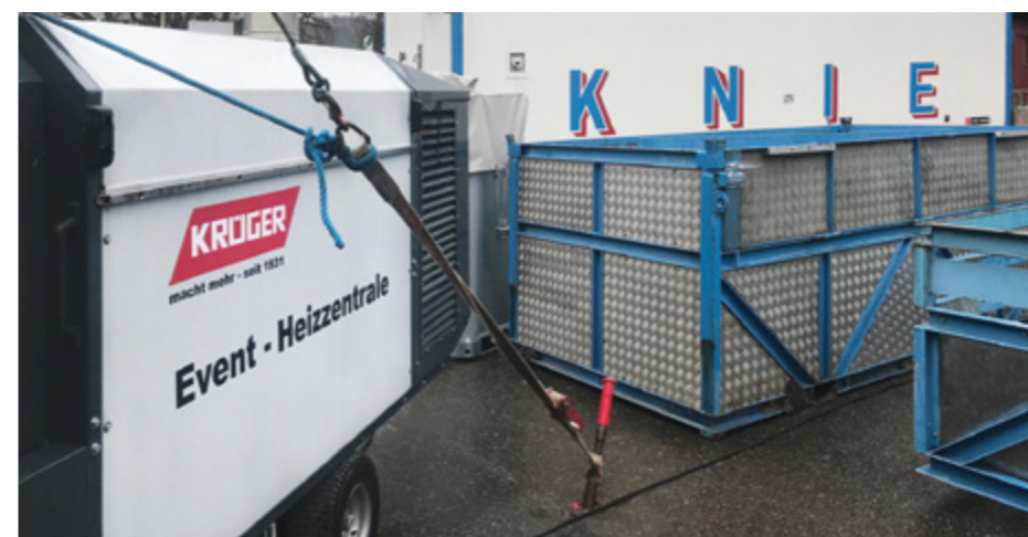
Während den Revisionsarbeiten sorgt eine mobile Event-Heizzentrale für angenehme Temperaturen.
