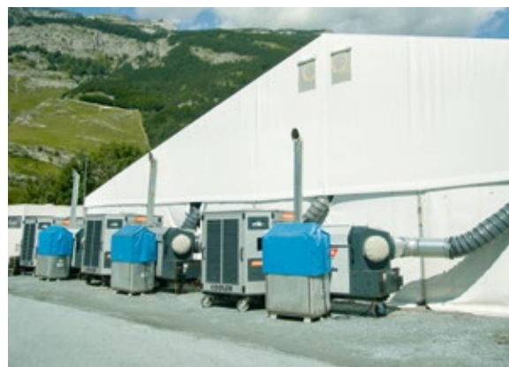
Heizen oder kühlen von Messezelten
