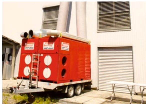
Temporäre Heizung für Tennishalle
